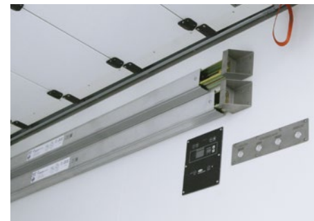
Bei Nichtbenutzung werden die Ladungssicherungsbalken seitlich an der Wand gesichert.
