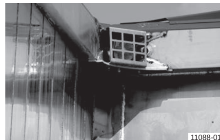
Sistemul de iluminare a interiorului benei
